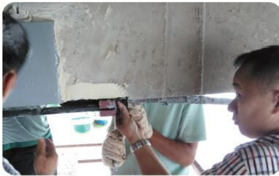
全面支持，根据需要派遣专业技术人员进行现场针对性施工指导
